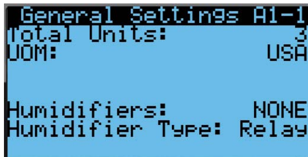
FIGURA 33 Habilitación del humidificador
